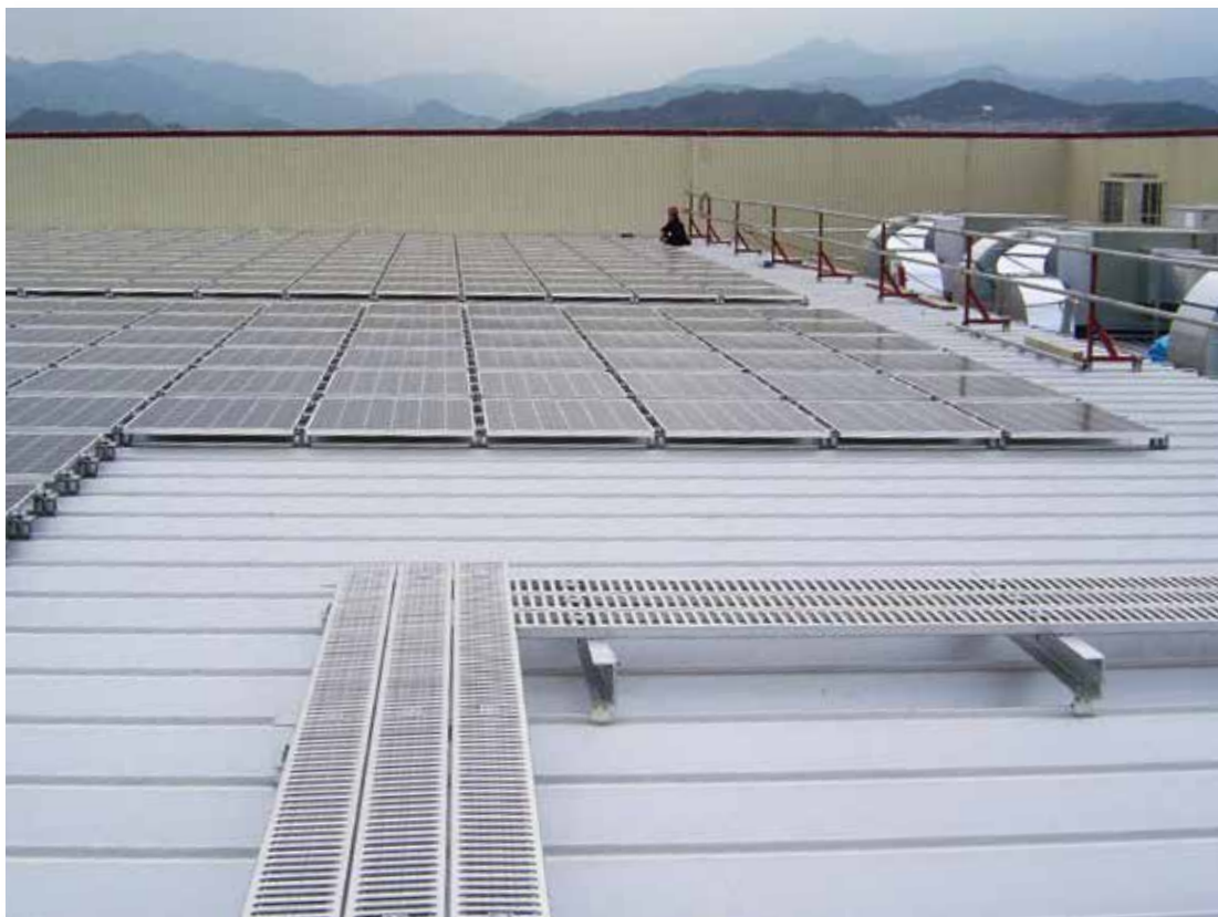
屋上点検通路（MN型）
